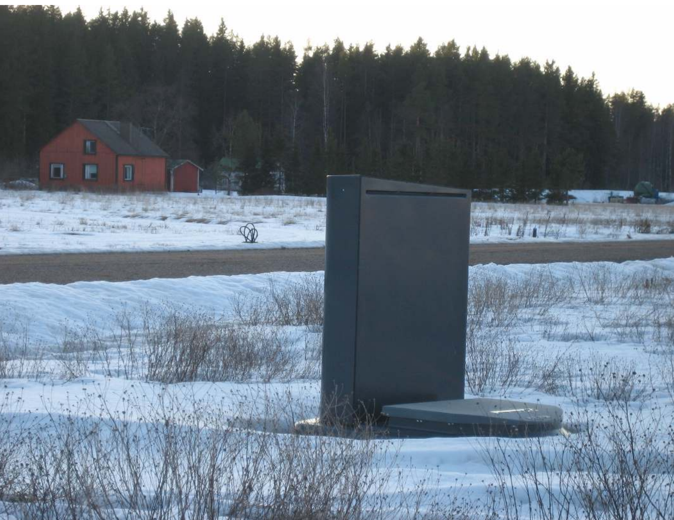
Jätevedenpumppaamo. (Kuva: Erkki Santala)
