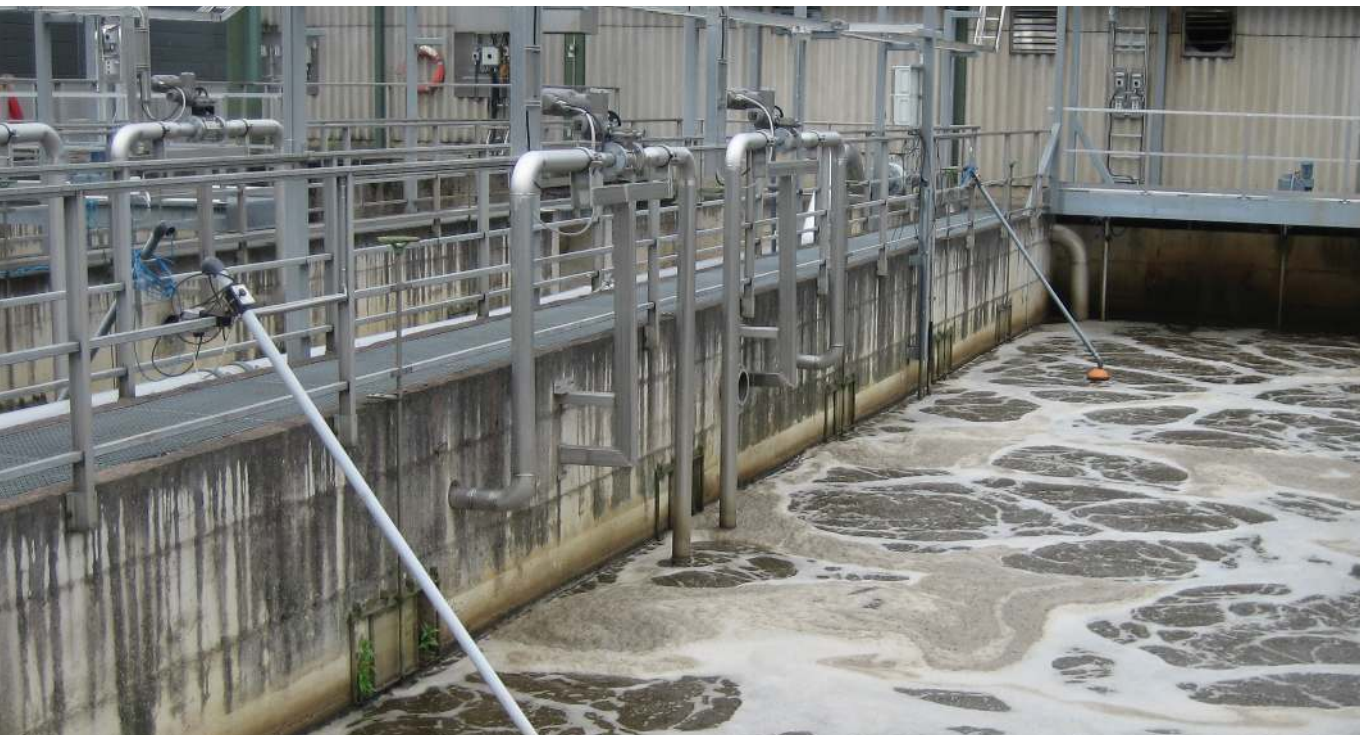
Jätevedenpuhdistamon ilmastusallas (Kuva: Jonne Säylä)
