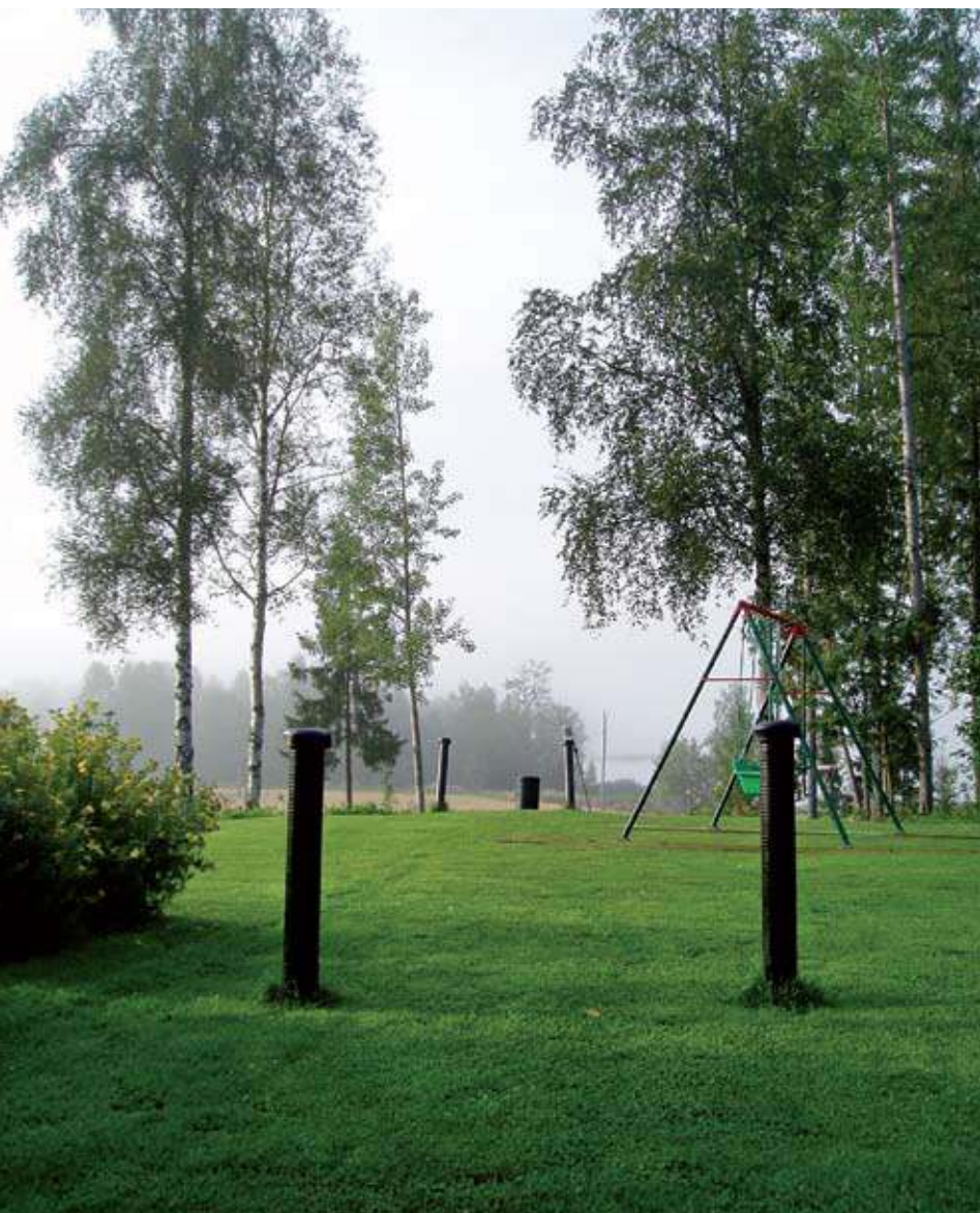
Tähän on rakennettu hyvin toimiva maasuodattamo pesu- eli harmaalle vesille. Kuva: Satu Heino
