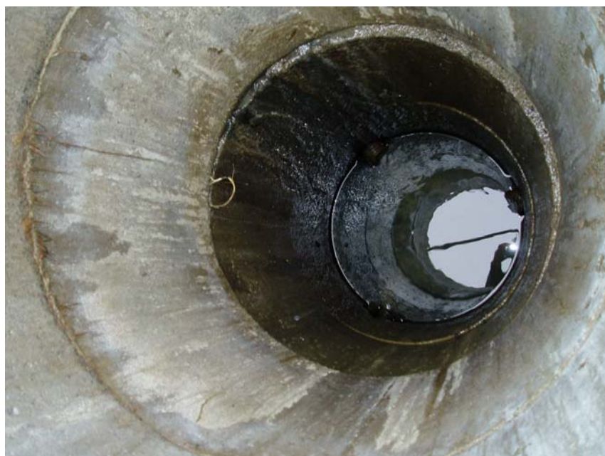
Kuva 9 Kokoomakaivoon valui sulamisvesiä betonirenkaiden välistä.
